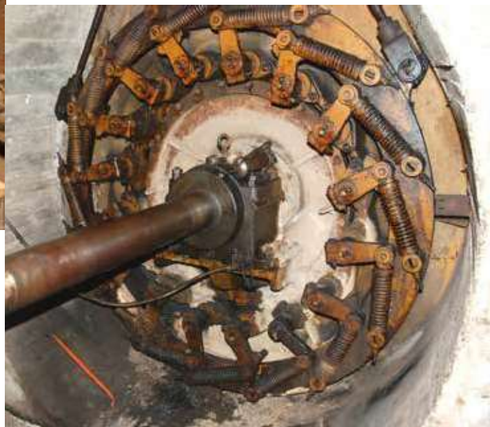
L'axe de la turbine et l'arrière du distributeur
